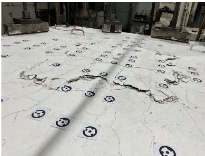
Obr. 4.3 Zlyhanie jednej z dosiek s GFRP výstužou
