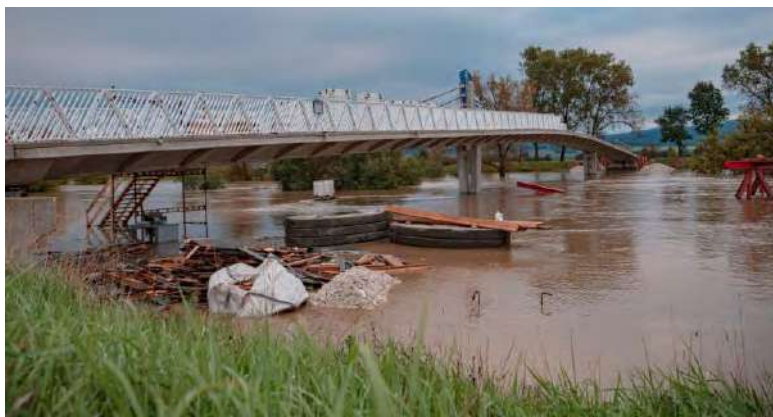
Obr. 6 Povodeň počas výstavby lávky
