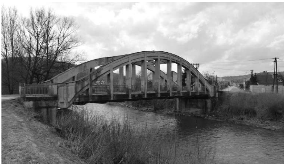
Obr. 1 Pohľad na most pred rekonštrukciou
