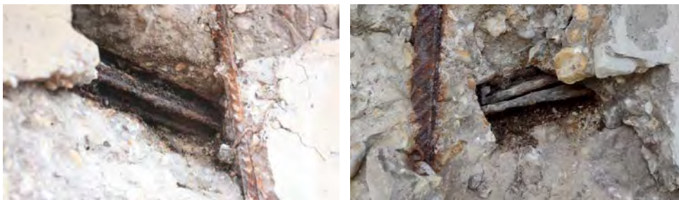
Obr. 4: Nezainjektované káblové kanáliky s korodujúcou predpínacou výstužou.
