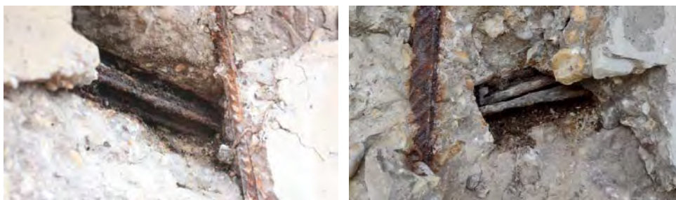
Obr. 4: Nezainjektované káblové kanáliky s korodujúcou predpínacou výstužou.
