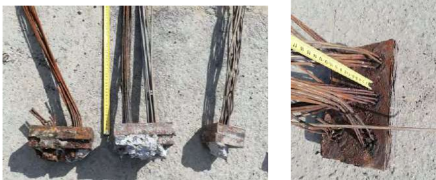
Obr. 5 Most Trstená: a) kotvy pozdĺžneho predpätia, b) detail odkorodovaných káblov priečného predpätia za kotevnou doskou
