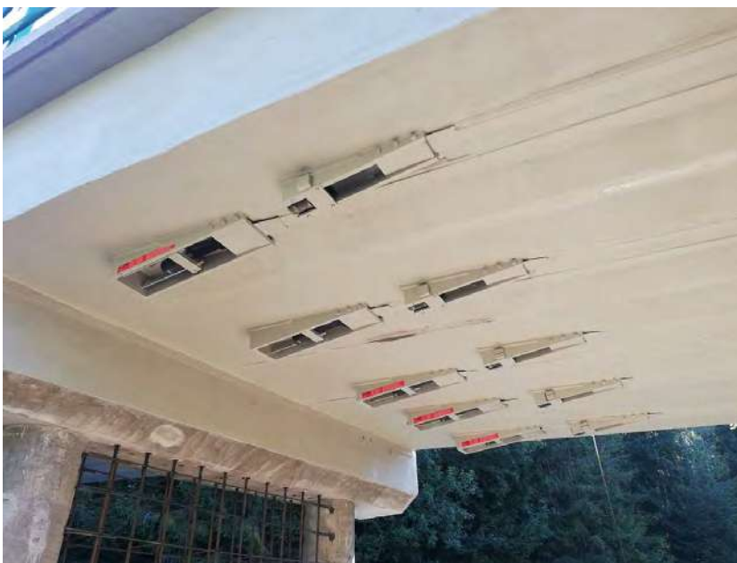
Obr. 5. Finálny pohľad na sanovaný a zosilnený most (detailný pohľad na kotvenie lamiel a deviátory)
