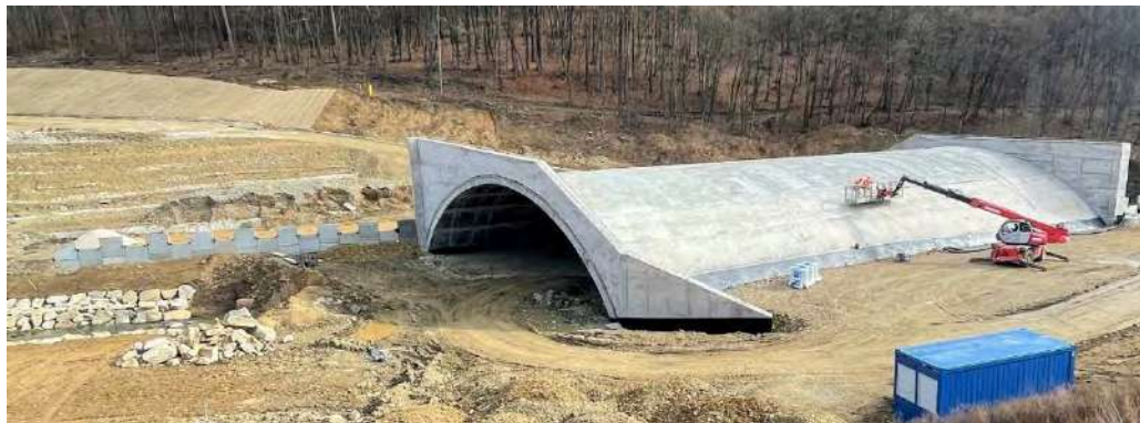
Obrázok 4. Realizácia mostného objektu SO 233 – pohľad na klenbu a portálové časti, realizácia násypu s postupným budovaním súvisiaceho oporného múru a prekládky potoka Dzikov (SO 322)
