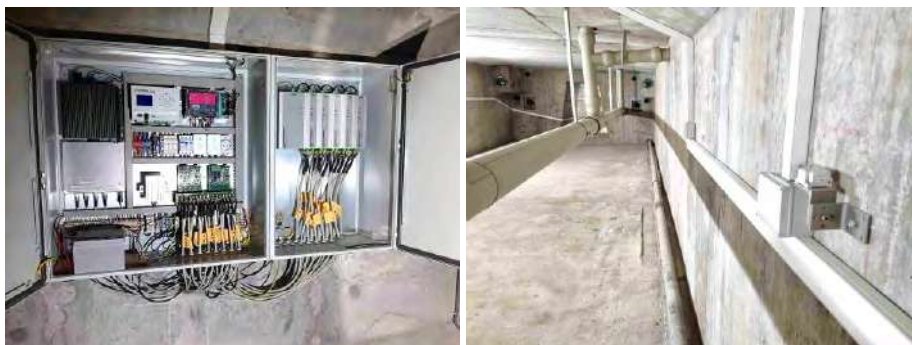
Obr. 7 Kabeláž od snímačov zvedená do meracích skriň a zapojená do PC zostavy
