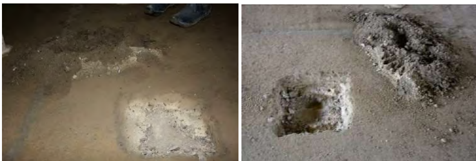
Obr.3 Poškodenie stropnej dosky s premrznutím
