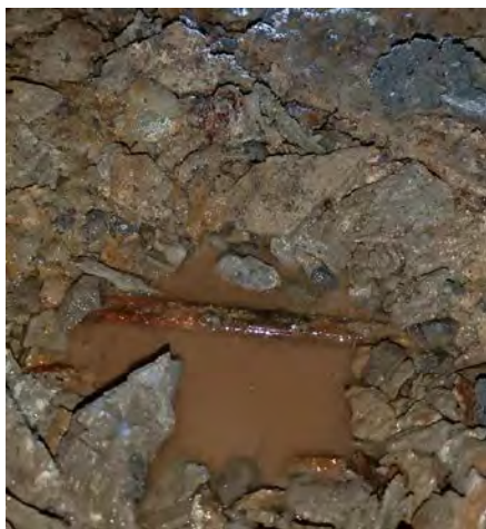
Obr. 3: Korodujúce predpínacie lano.
