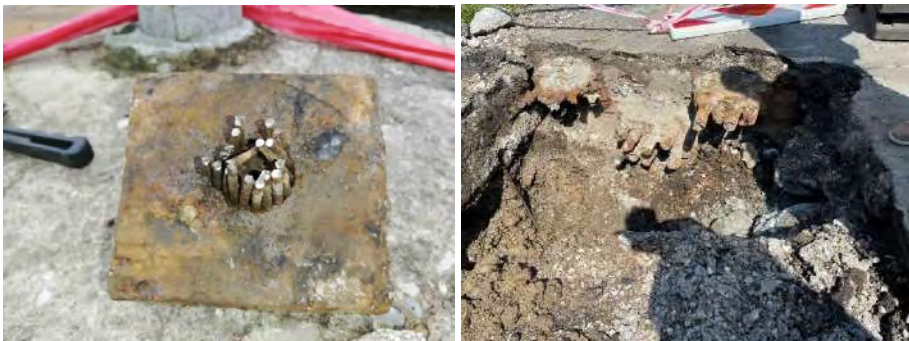
Obr. 4 – Detail odobratej kotvy (vľavo), kotevná oblasť (vpravo).
