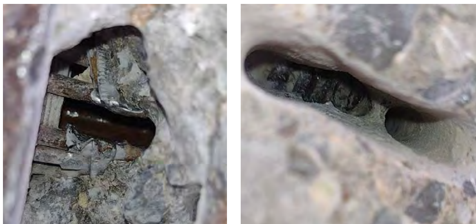
Obr. 6: Nezainjektované predpínacie laná v spodnej doske prefabrikátu; v ľavo miesto kotvenia, v pravo približne 0,5 m za kotvou.
