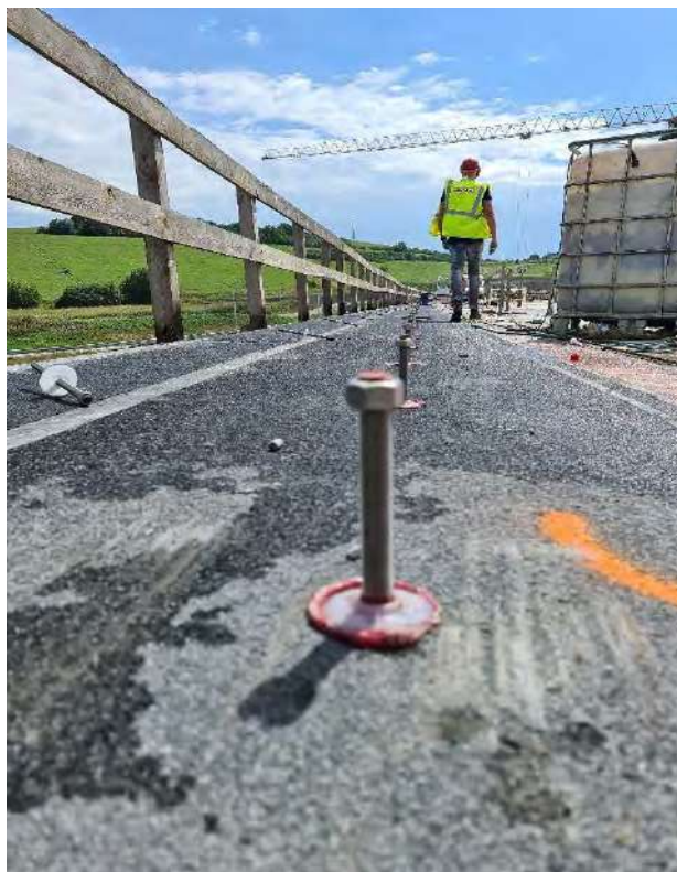
Obr. 4 Pohľad na zabudovaný systém rímsových kotiev HPA na moste 201-00
