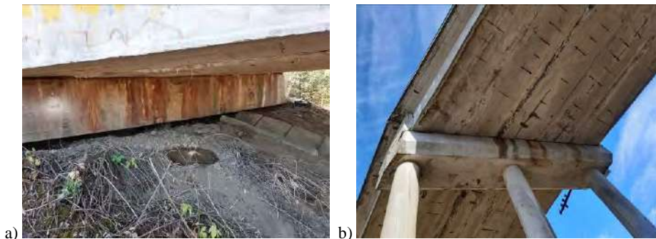
Obr. 2 Poruchy na mostoch – priesaky medzi nosníkmi a priesaky (netesnosť) cez dilatáčn é škáry na oporách (a), priesaky cez dilatáčn é škáry na úložných prahoch piliera a korózia strmeňov nosníkov (b)
