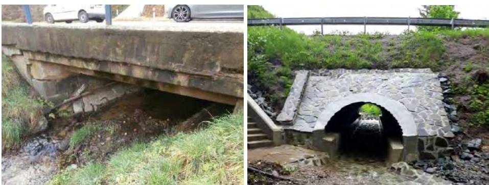
Obr. 4 – a) priečný rez mosta po rekonštrukcii , b) pohľad na poruchy mosta, c) ilustračný obrázok mosta po rekonštrukcii pomocou technológie „relining“
